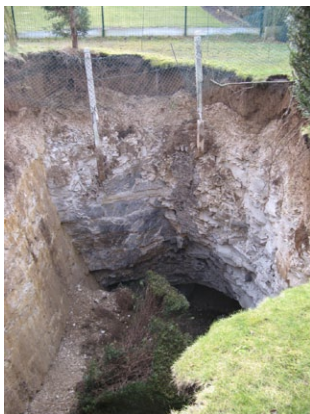
Effondrement d'une catiche à Faches Thumesnil (Source : BRGM)
